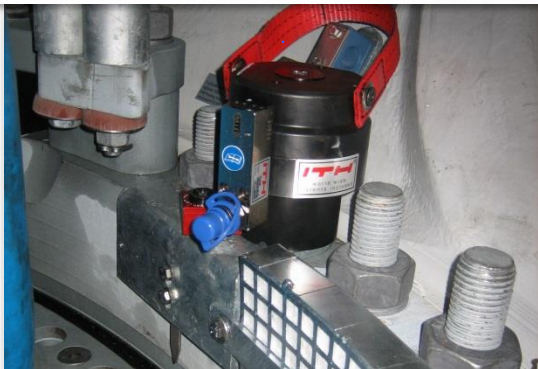
Conexão de parafuso de torre
