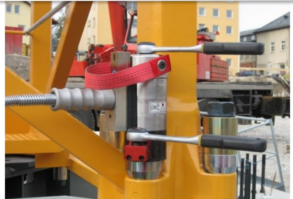
União aparafusada em segmento de guindaste de construção
